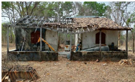
Edificação em ruína
