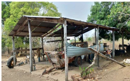
Galpão em ruína
