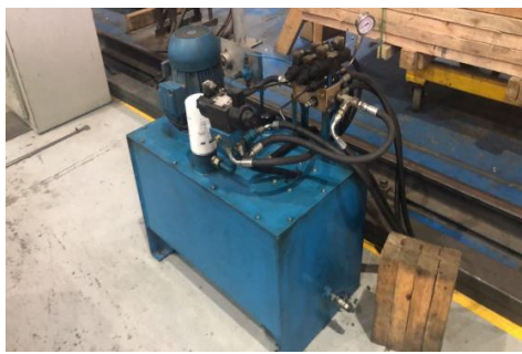
Vista do Sistema Hidráulico
