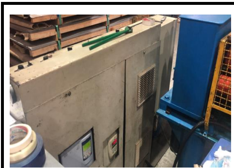
Vista do Sistema Elétrico / Painel de Controle
