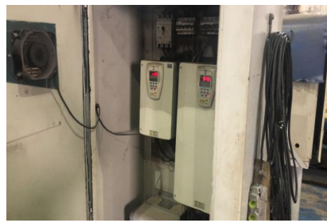
Vista do Sistema Elétrico de Automação
