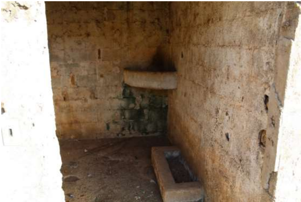
Foto 12 – Edificação rudimentar na parte baixa do imóvel (local sem uso, aparenta ser destinada a criação de animais)
